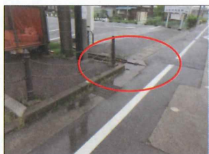
段差があり危険
